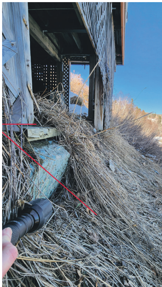
Plusieurs ancrages de béton soutenant la structure de bois de la promenade en face de la petite chapelle sont fragilisés. Photo Courtoisie
