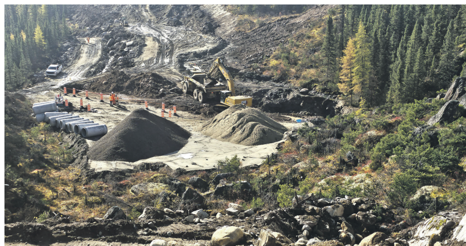
En 2023, une partie des travaux ont été effectués sur la route 389 entre Fire Lake et Fermont. Photo MTMD
